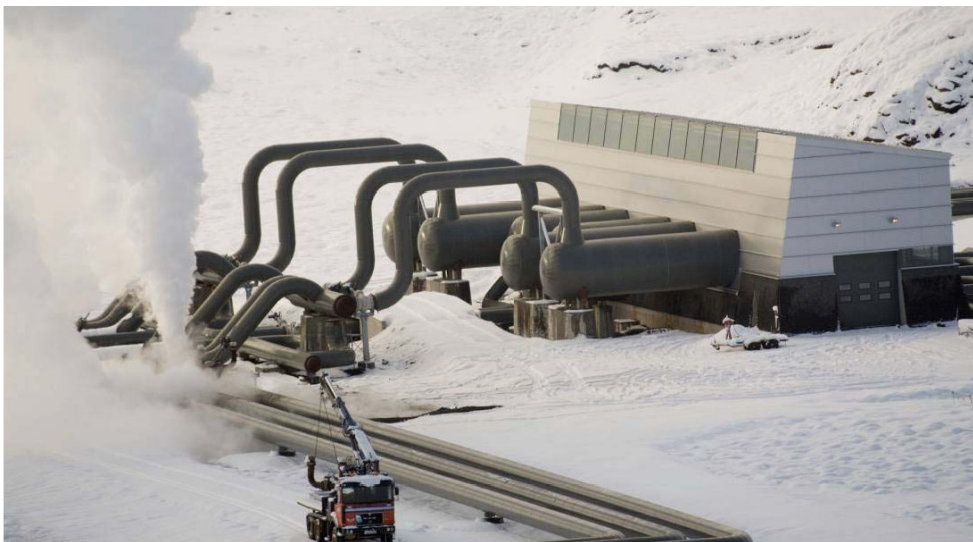
Mynd 12.10 Skiljustöð við Hellsheiðarvirkjun.
